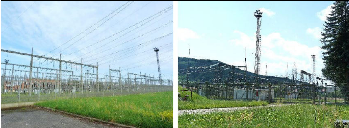
Felsőzsolca és Sajóivánka 400/132 kV-os alállomások
